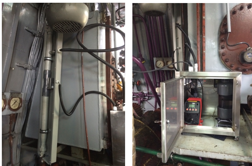
Rys. Instalacja systemu katalizacji przy zbiorniku rozchodowym paliwa
